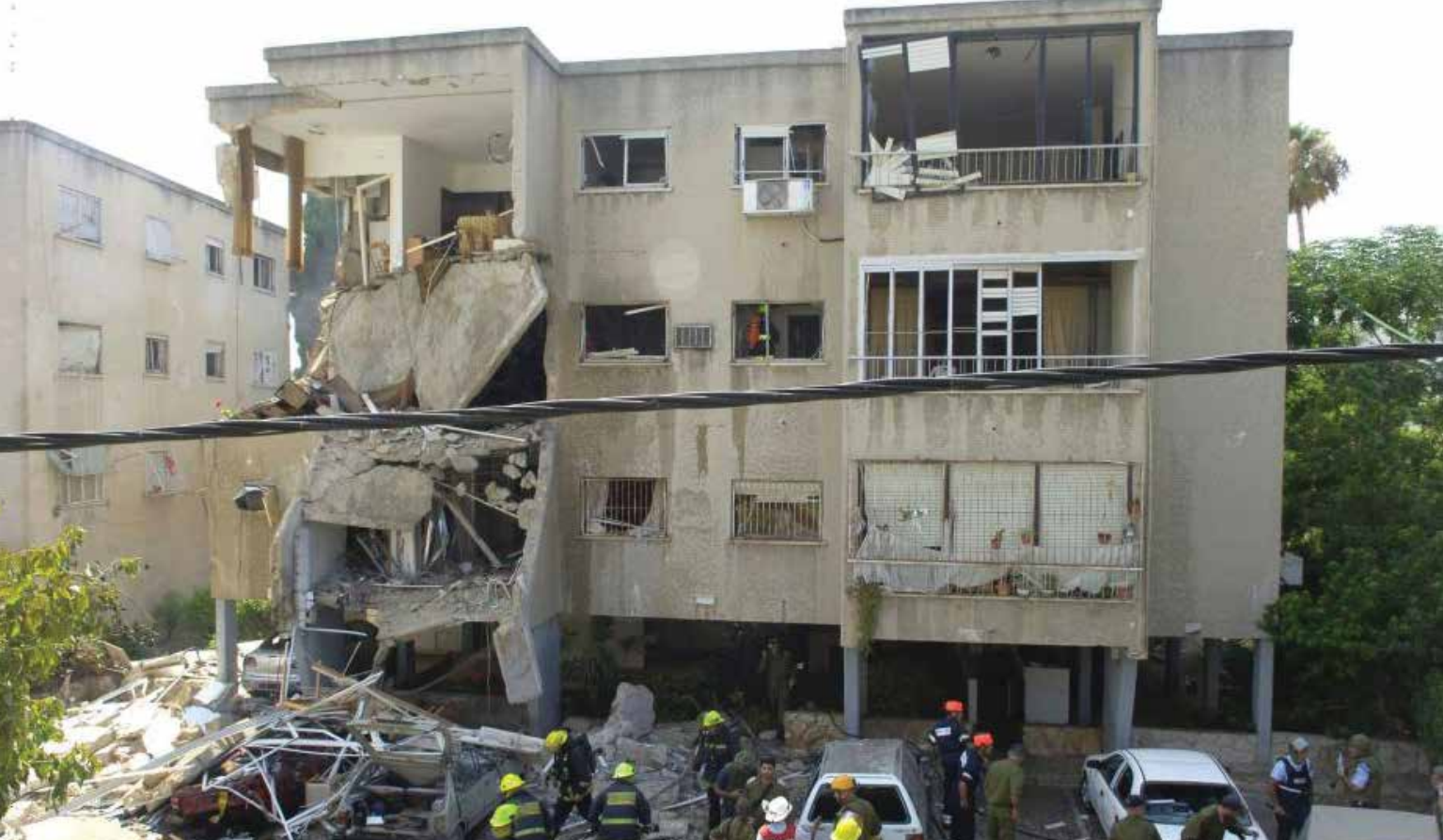
בניין מגורים בחיפה שנפגע מירי רקטה במלחמת לבנון השנייה | במלחמת לבנון השנייה הייתה התעלמות כמעט מוחלטת ממקומו של העורף במלחמה: יותר ממיליון אזרחים ישבו במקלטים במשך יותר מחודש. וכל המערכות - השלטוניות והביטחוניות - התעלמו מהמציאות הזאת
