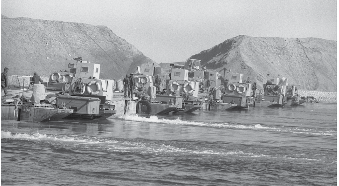
בניית גשר הדוברות בתעלת סואץ. הצורך בארגון "החצר" למתחם רב תפקודי ניכר עם הגעת הדוברות בבוקר 17 באוקטובר והתחלת בניית הגשר. צילום: אברהם ורד, דו"ץ
